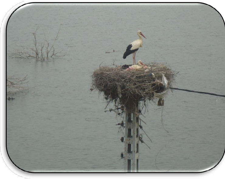
Photo 01 : Nid sur un poteau électrique à Oued laktan : Elafri A, le : 06 Avril 2016).
